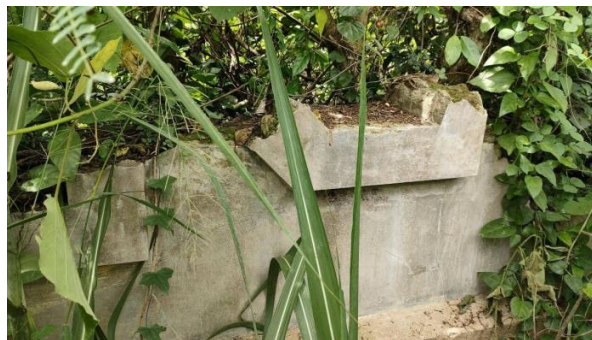
Hình 2. Trại An Trí Trà Kê- Huyện Sơn Hoà bị xuống cấp nghiêm trọng. Nguồn: Tác giả
